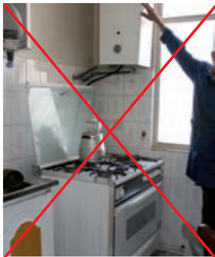
شکل ۱-۶ نصب نادرست آب گرم کن.
