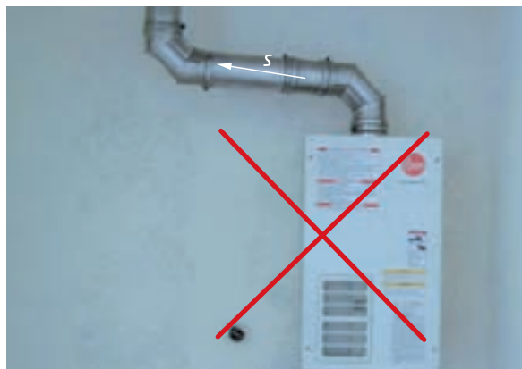
شکل ۱-۳۶ اتصال نادرست دودکش
